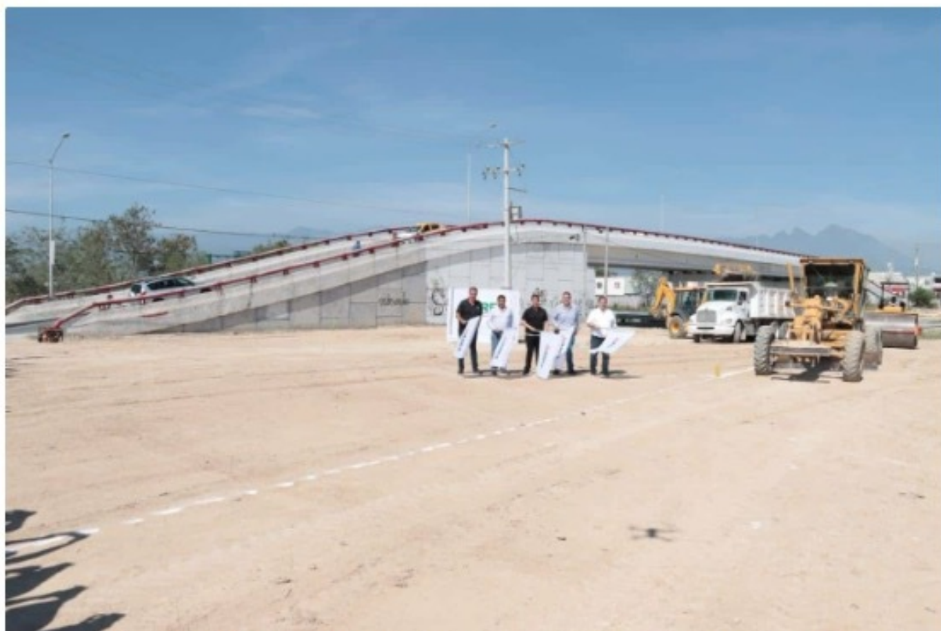
En el puente vehicular conocido como la Montaña Rusa se han suscitado múltiples accidentes, por el alcalde de Juárez, Francisco Treviño Cantú arrancó la reconstrucción de la obra. FOTO: Cortesía
